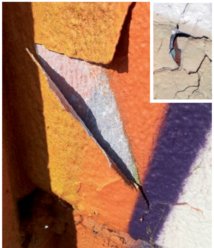
Abb. 14: Schäden durch Frost und Feuchtigkeit
