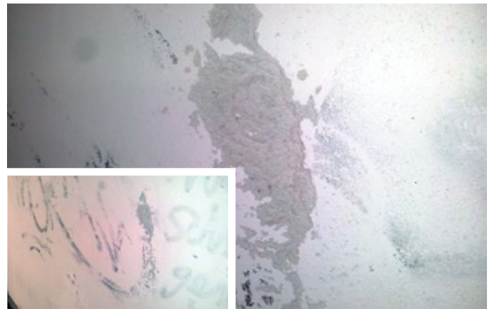
Abb. 17: Schäden an Putzschicht durch Wasser-Hochdruck
